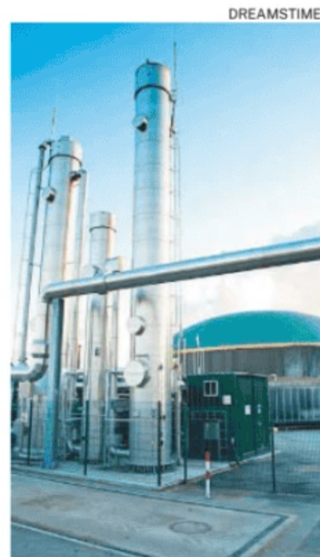
Planta de biogás
