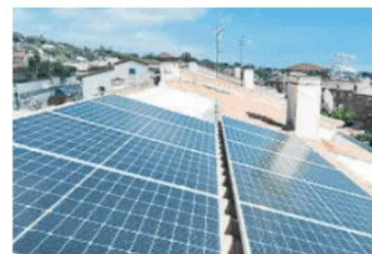
Instalaciones de autoconsumo en dos edificios
